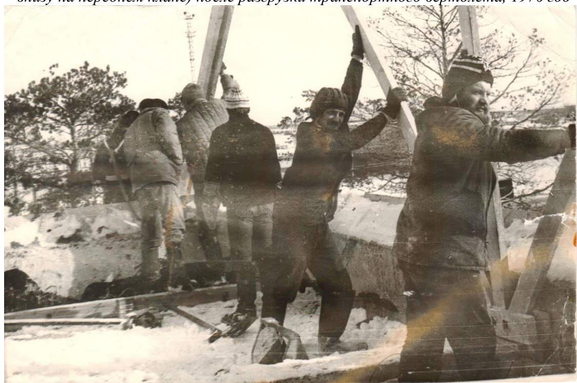
ФД.Оп.4.Д.164.Л.1 Бригада строителей Леонида Павловича Кудрявцева Строительно-монтажного поезда №524 во время строительства первой школы. Среди присутствующих: Леонид Николаевич Процукович – плотник (первый справа), Юрий Андреевич Калиниченко – мастер (второй справа), 1977 год
